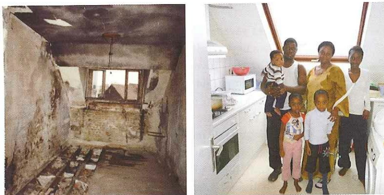
Grâce à Rénovassistance, des immeubles insalubres deviennent des logements à finalité sociale.
